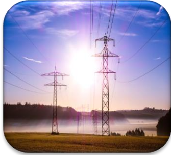
Grau en Enginyeria Elèctrica (EEBE, ESEIAAT, EPSEVG)
